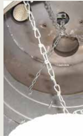
Detail čistícího zařízení.
