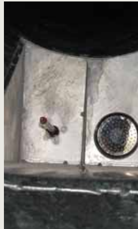
Detail protipožární sondy a požárního zařízení.
